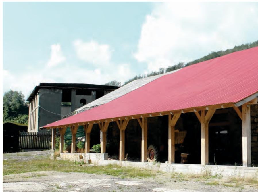
Intervenții noi cu materiale de construcție neadecvate / New interventions using inappropriate building materials
